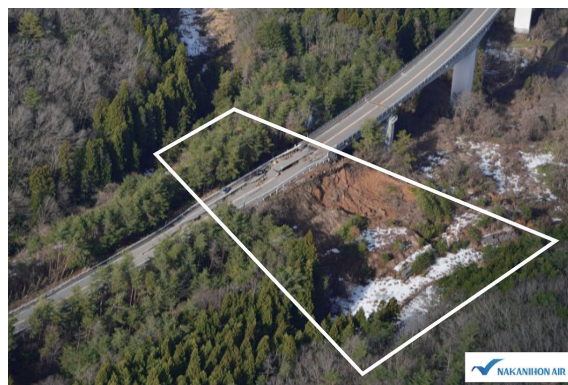
図3 被災した能登大橋(斜め撮影)
