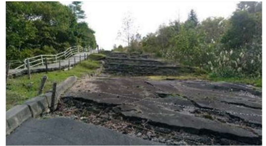
図4. 西山火口散策路の隆起した国道
